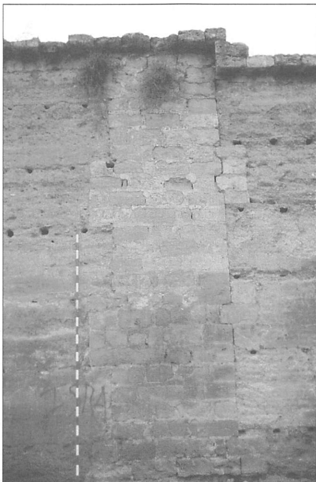
Foto 2. Machón de sillería contemplado desde el espacio intramuros que engarza en cremallera con los cajones de tapia.
