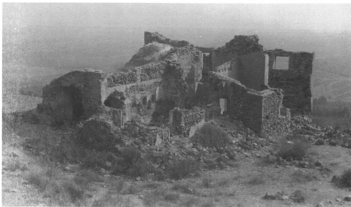
Vista de conjunto de la Capilla de los Angeles del Monte Miral por la parte trasera. Pese al derrumbe de techumbres y partes superiores de sus muros, conserva todavía el trazado de su planta y los materiales constructivos que facilitarían su restauración. Arriba el aspecto que presentaba en los años veinte.
