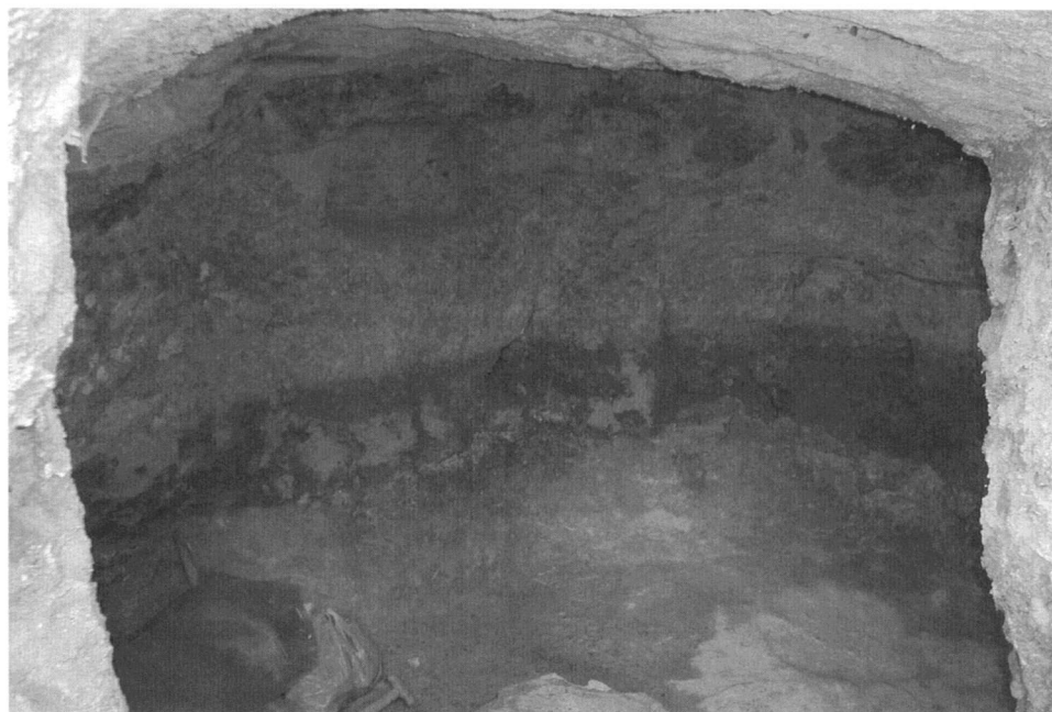
Afloramiento de agua a través de la roca.
